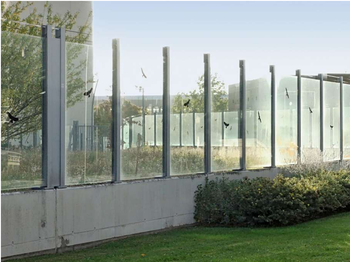
Les silhouettes autocollantes de rapaces indiquent en général que des problèmes de collision ont été constatés. Elles ne contribuent toutefois pas à atténuer les risques et ne devraient pas être utilisées, car des oiseaux continueront à voler contre les vitres à côté des silhouettes. Un marquage éprouvé, couvrant l'ensemble de la surface, doit être utilisé.
