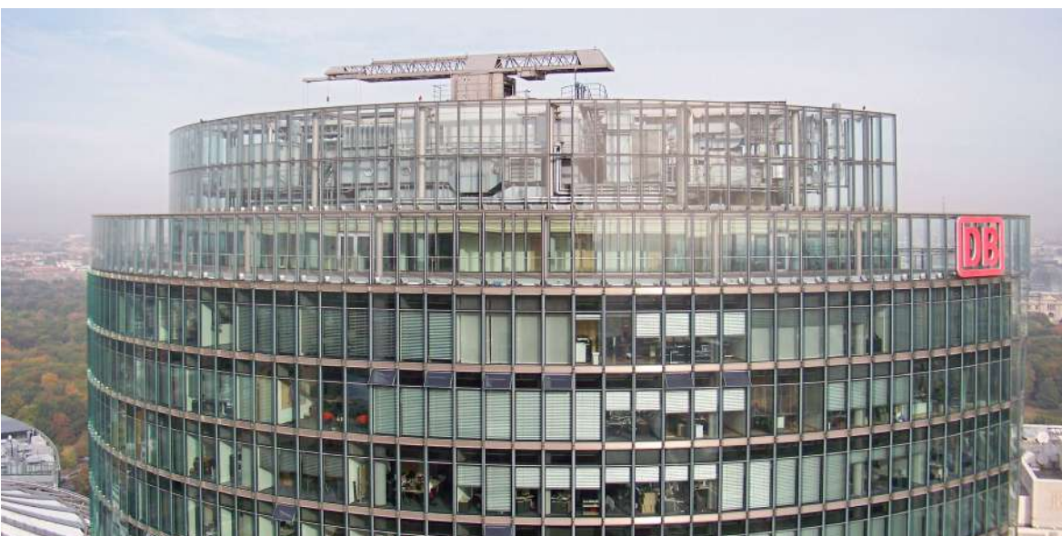
Attique vitrée de plusieurs mètres de haut sur une tour : les oiseaux ne heurtent pas seulement les parois extérieures, mais entrent aussi en collision depuis l'intérieur une fois entrés dans l'espace librement accessible.
