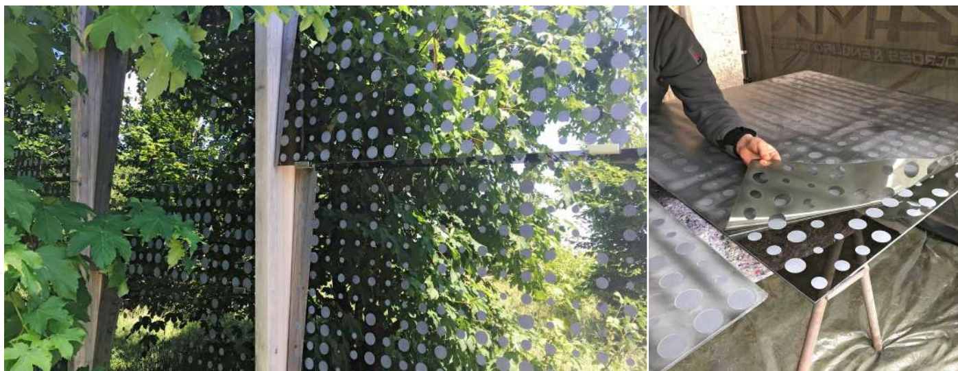
Une façade sablée après coup à Schamstein (Autriche): pour les modifier à des fins de protection des oiseaux, ces vitres très réfléchissantes ont pu être déposées de la façade. Elles ont ensuite été traitées sur place par un sablage partiel (trame de points de différents diamètres).
